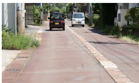
消雪設備の改修を待つ町道琴平線
