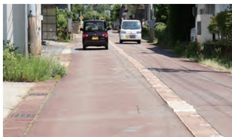
消雪設備の改修を待つ町道琴平線
