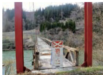
老朽化で通行止め
