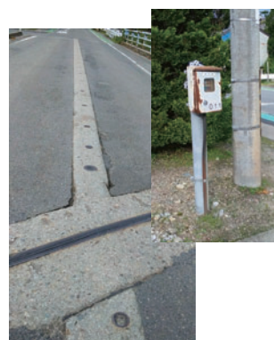
水源が枯れた消雪設備
