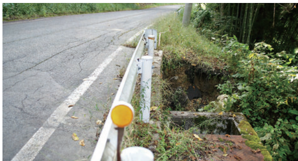
法面崩壊の坂下平田中山線
