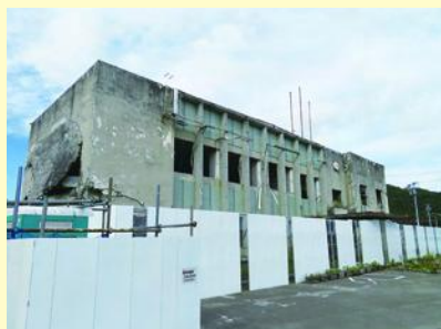
被災した大槌町役場
