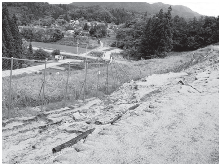
鷹山小学校の法面崩壊の現場
